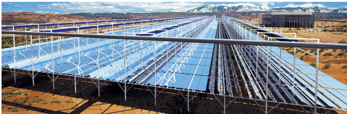
Solkraftwerk mit vier Sonnenkollektor-Strängen jeweils 1000 m lang
